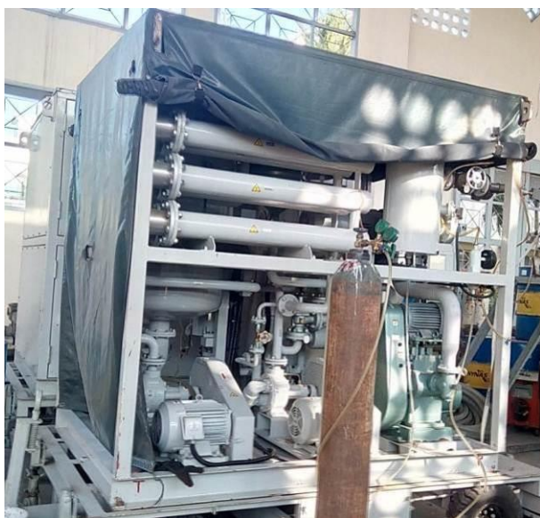
Máy lọc dầu
