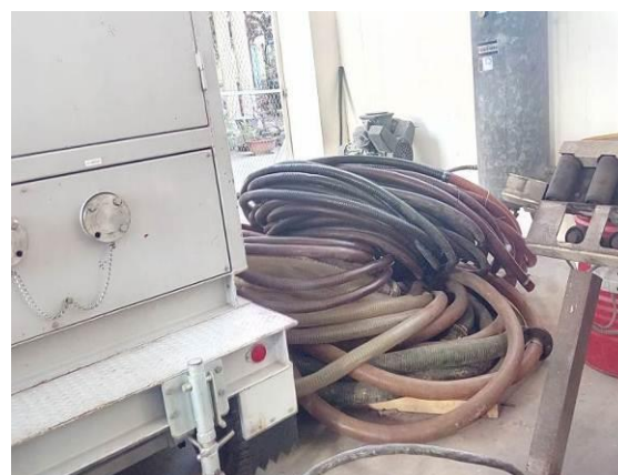
Các loại ống dẫn dầu nối máy lọc với máy biến áp
