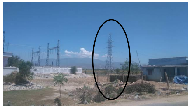
Cột đầu nối vào TBA 110kV Ninh Hải
